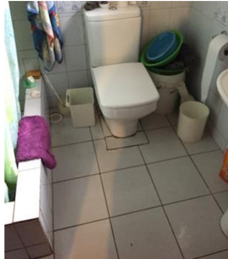
Figura 9 WC sin barras de sujeción y sin espacio para radio de giro de silla de ruedas
