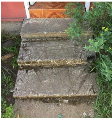
Figura 3 Entrada a vivienda con ausencia de pasamanos y con puerta que mide menos 80 cm de anchura
